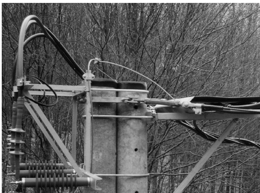
Подключение линии СИП до 42 кВ к выключателю
