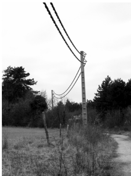
Две линии СИП среднего напряжения на одной опоре
