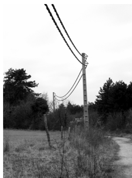
Две линии СИП до 42 кВ на одной опоре
