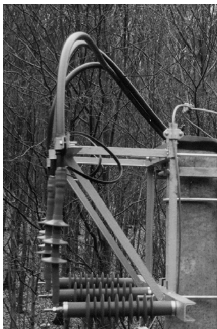
Концевая муфта на линии СИП до 42 кВ, смонтированная наконечниками вниз, для подключения к выключателю
